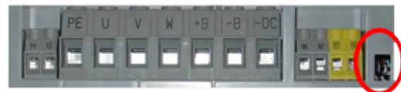
Parte inferior de los equipos
